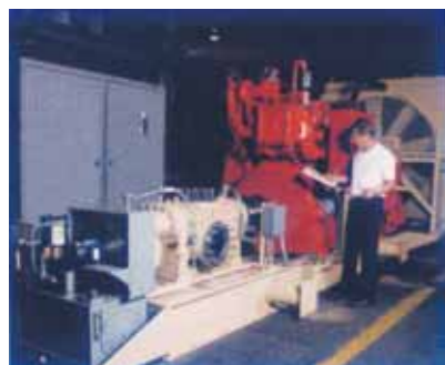
Типовой насос с приводом на природном газе для перекачивания сырой нефти по трубопроводу.
